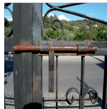
FIGURA 37 Esempio di corrosione
